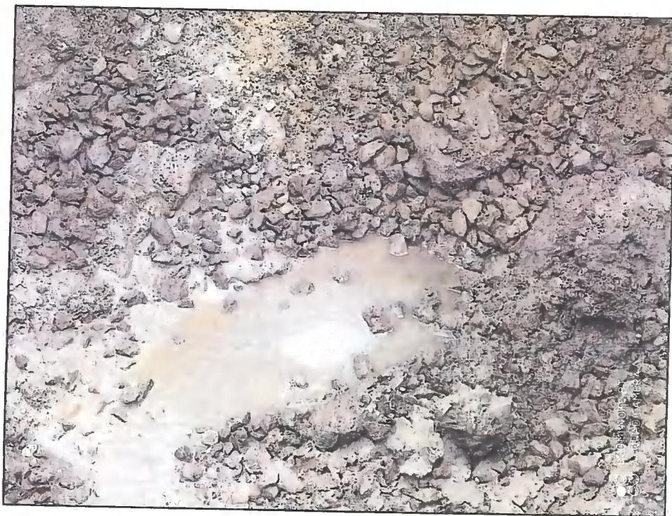
obr. 1 - ztekucování písků okamžitě po odkrytí výkopu
