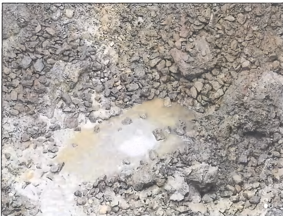
obr. 1 - ztekucování písků okamžitě po odkrytí výkopu
